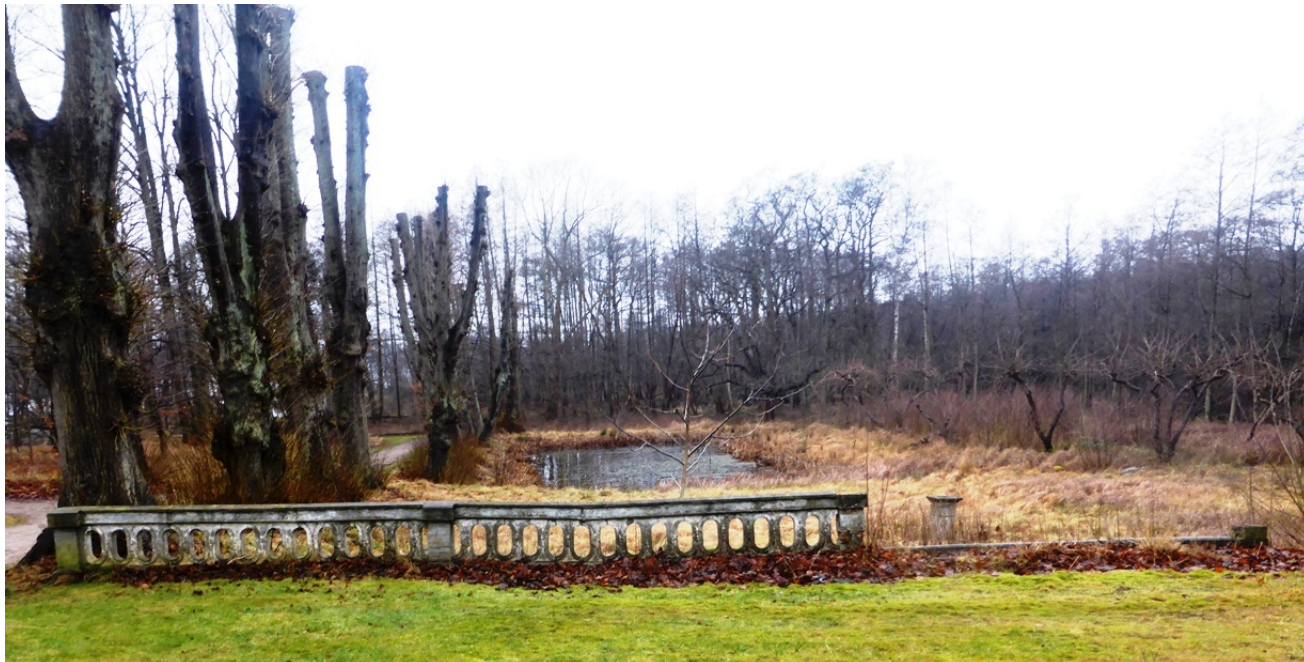
Balustraden på Kaningården, der trænger hårdt til en renovering
